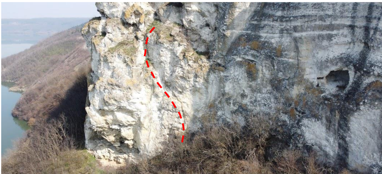
Рисунок 6 Тріщина відсідання, що січе скелю
