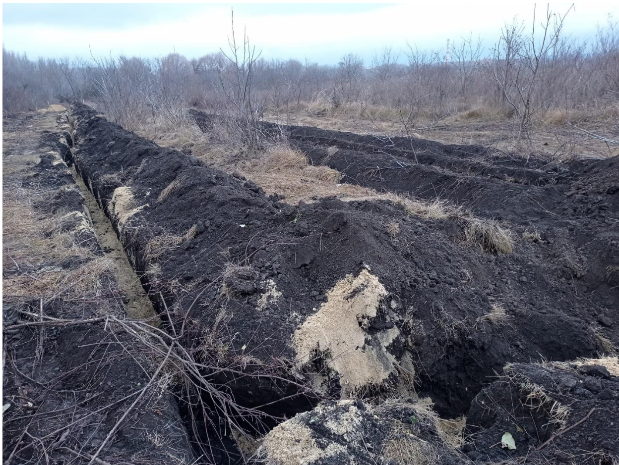
Рис. 11. Прокладання кабелів на суміжній ділянці – потенційна загроза для зимових оселищ тритона гребенястого.
